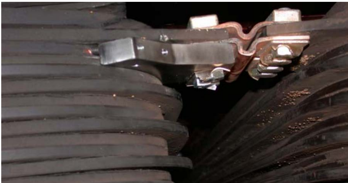
Рис. 2. Вид замыкания в полюсе 78 МВА генератора
